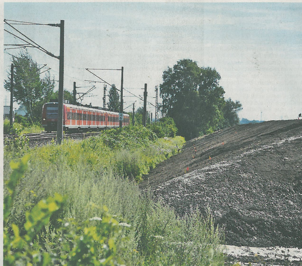
Der Lärmschutzwall im Norden des Baugebietes wurde modelliert und ist mit Mutterboden überdeckt. Im Herbst soll er bepflanzt werden. Die Erde stammt aus dem Bereich der Ausgleichsflächen. FOTOS: KREBS (2)
